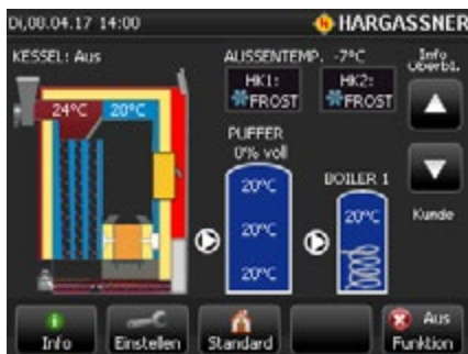
Kessel vor der Inbetriebnahme: Das Display der Lambda Touchtronic zeigt Ihnen einen nicht beheizten Kessel. Der Boiler und der Puffer sind kalt bzw. nicht geladen.
