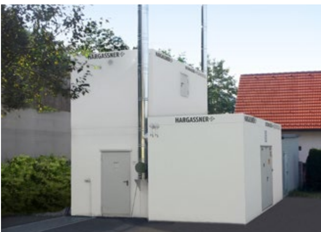
Dreifachstock-Heizmodul bei Gastronomiebetrieb.
